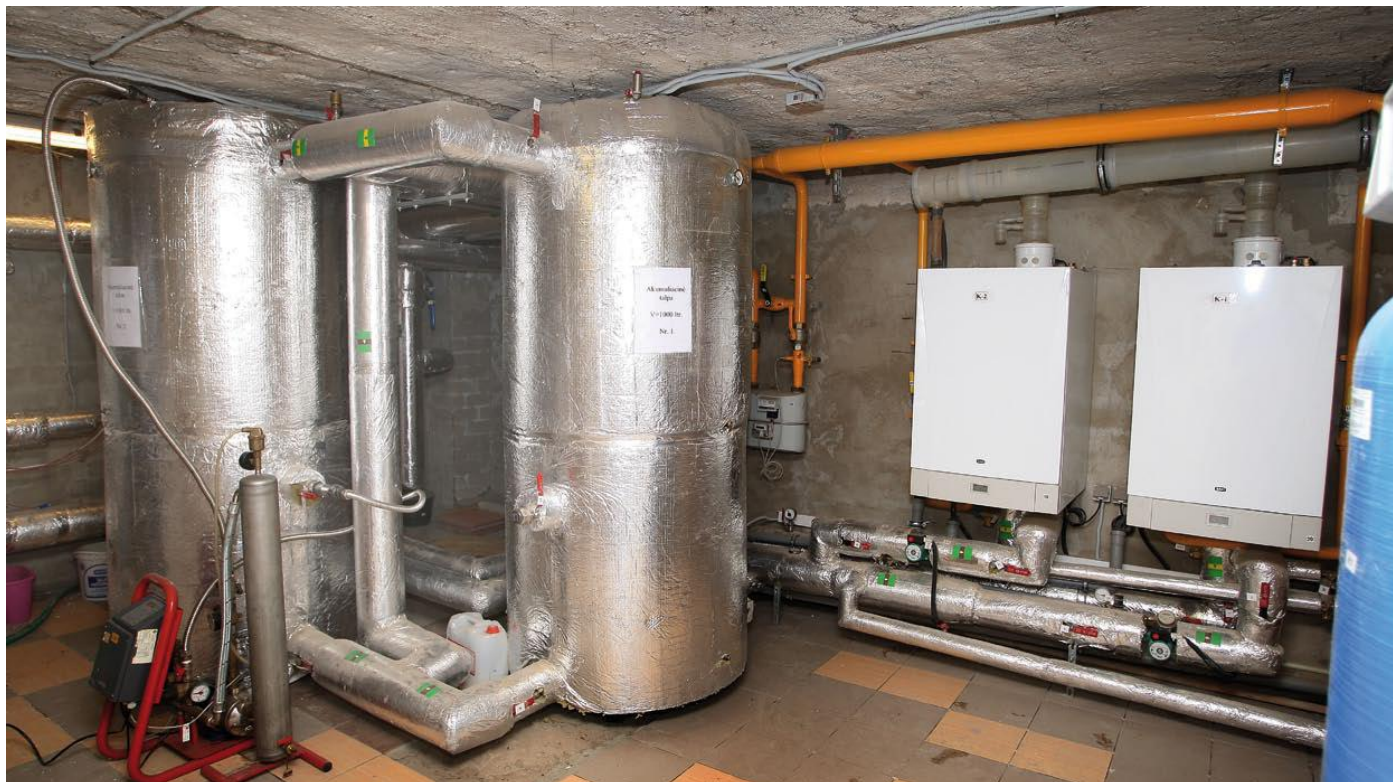
Buvusio šilumos punkto vietoje įrengta nauja katilinė. Tai du firmos „Baxi“ dujiniai kondensaciniai katilai akumuliacinės talpyklos priimti šilumą iš saulės kolektorių.
