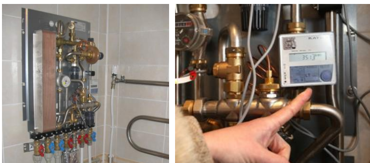
36 butuose įrengti šilumos mazgai, reikiamu momentu ruošiantys karštą vandenį ir individualiai skaičiuojantys bute suvartotą šilumos energiją.
