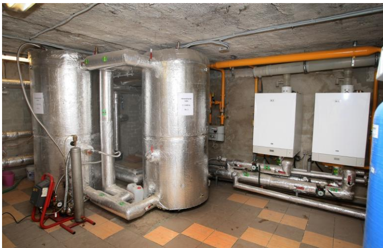
Namas įsirengė modernią dujinę katilinę.
